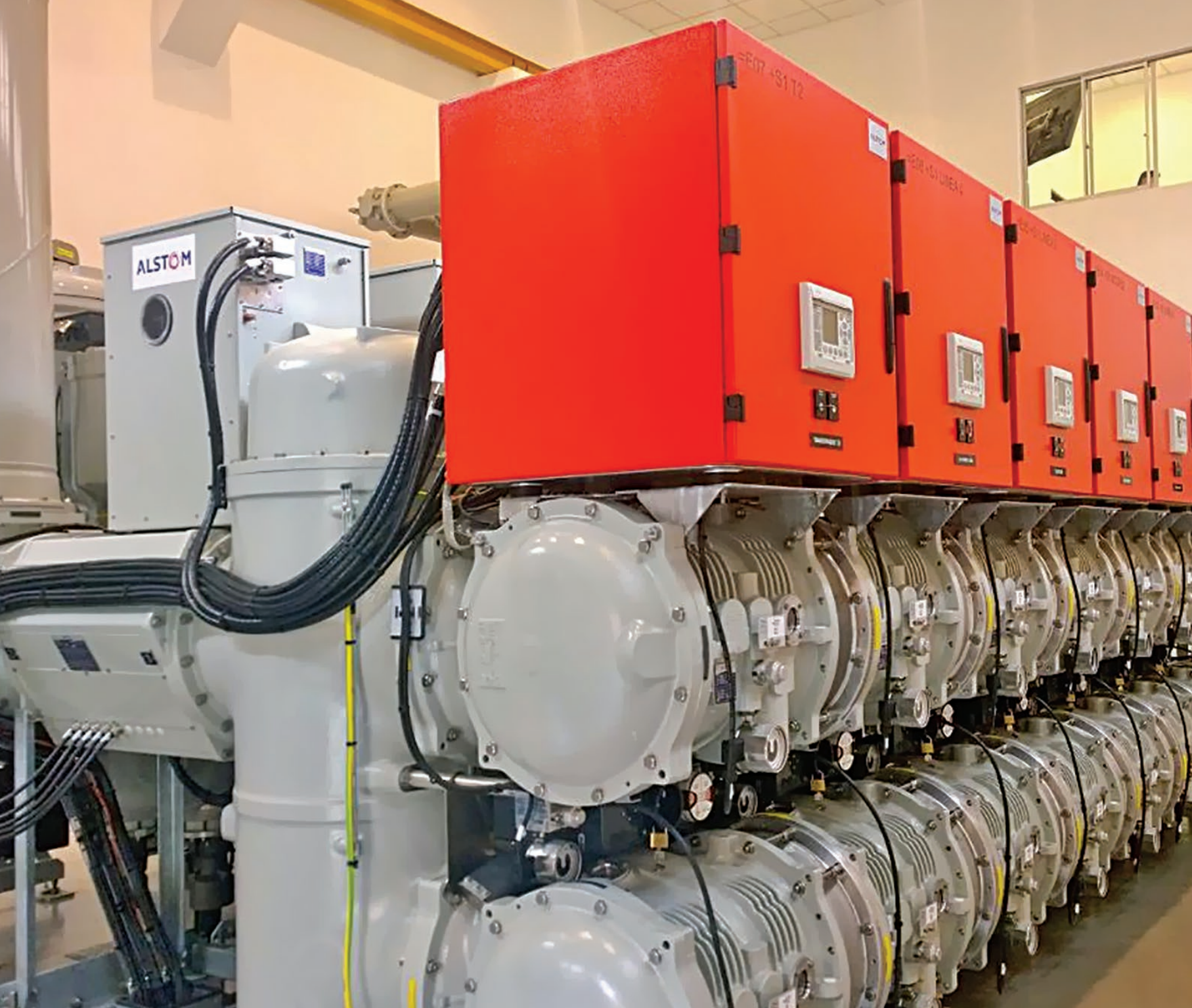
Sub- estación de energía eléctrica
